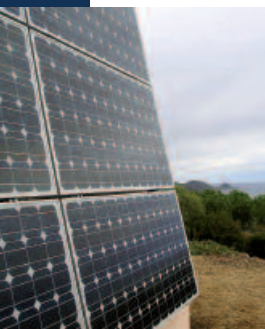
► Une centrale photovoltaïque au Maroc permettrait d'exporter de l'énergie.
